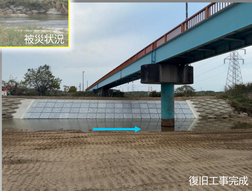
国災第47号 二級河川朝明川(左岸) (四日市市朝明町地内)
