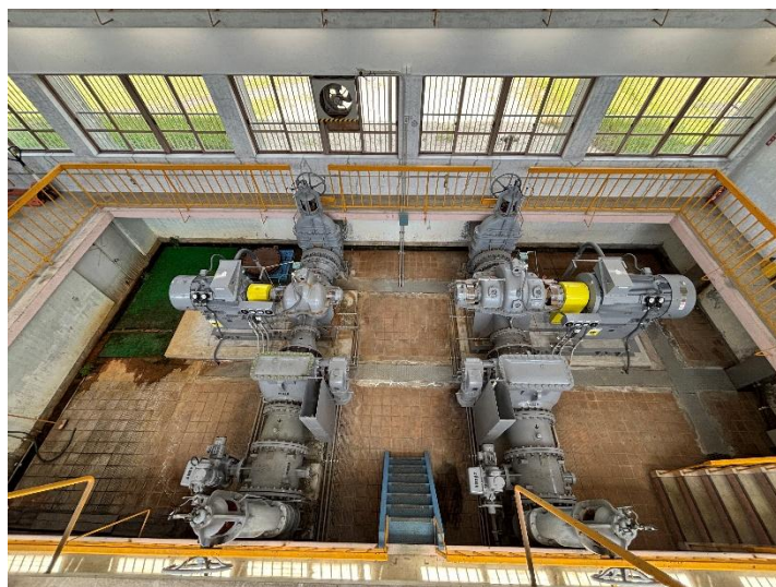
分解点検予定の伊坂ポンプ所 取水ポンプ設備（四日市市）
