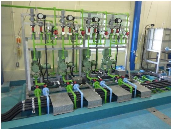
更新予定の伊坂浄水場 薬品注入設備（四日市市）
