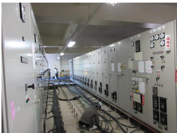
更新予定の高野浄水場受変電及びポンプ電気設備 （津市）
