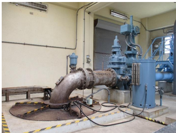
分解点検予定の高野浄水場 送水ポンプ設備（津市）
