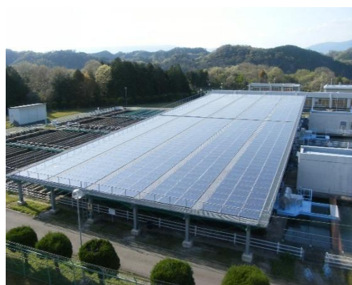
高野浄水場太陽光発電設備（津市）
