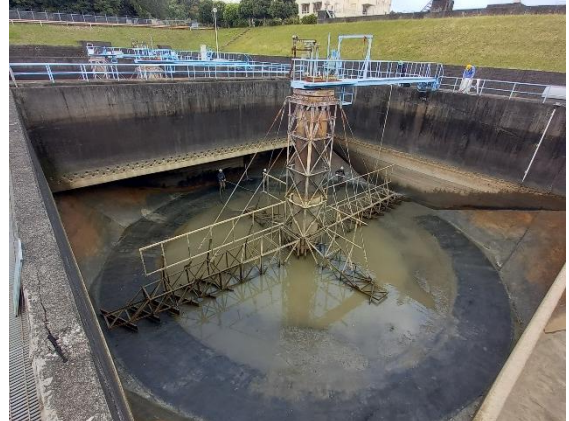
更新予定の山村浄水場 汚泥池搔寄機（四日市市）
