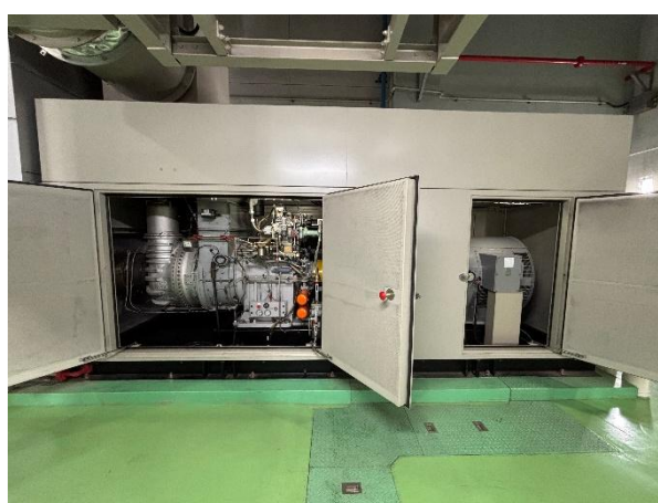
更新予定の播磨浄水場非常用発電設備 (桑名市)
