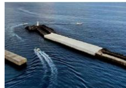
防波堤のかさ上げ
