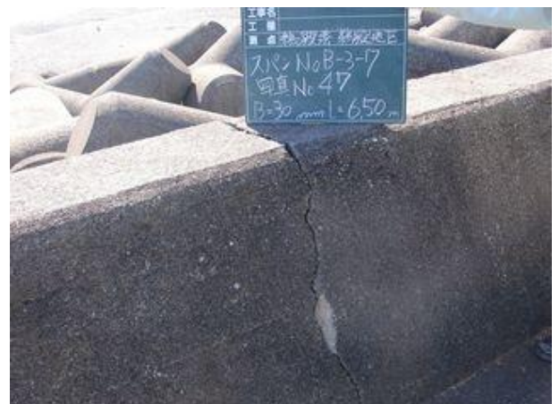
変状：ひび割れ(鵜殿港鵜殿地区)
