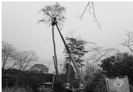
＜生活環境林整備事業＞ キャンプ場に隣接する危険木の除去
