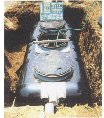
合併処理浄化槽
