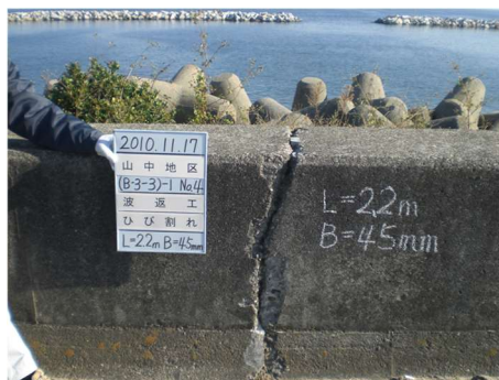
波返し工ひび割れ (三重県鈴鹿市)
