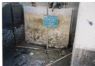
ヘドロの堆積 (フラップゲート)
