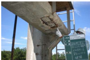
破損 (スライドゲート)
