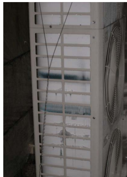
霜が付着した室外機
