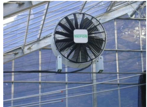
空気の流れをつくる循環扇
