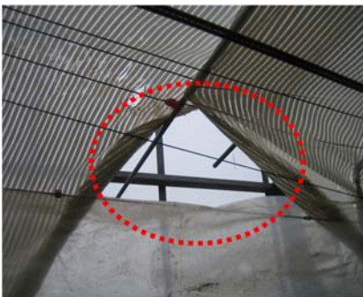
天井カーテンの隙間（妻面）
