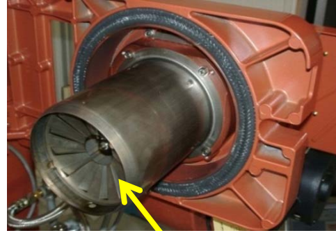
清掃後のエアコーン、ディフューザーの状態
