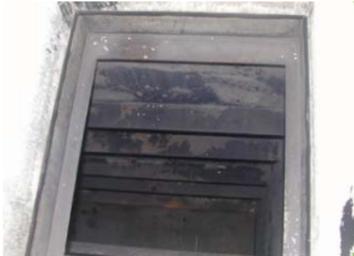
腐食抑制剤を使用している缶体
