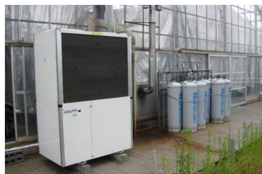
ガスヒートポンプ（室外機）
