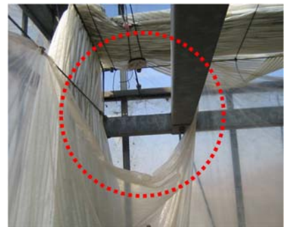
温室のコーナー部の隙間
