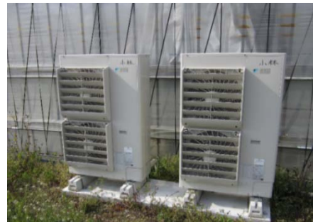
風向ガイドを取り付けた室外機
