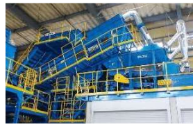
プラスチック高度選別設備
