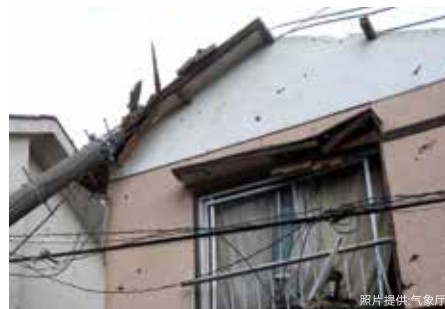
被倒塌的电线杆砸坏的房子
