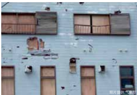
被飞来物品砸坏的墙壁
