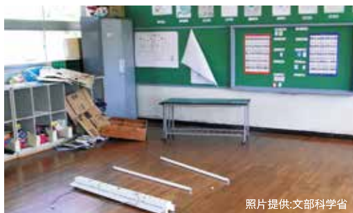
掉落的日光灯
