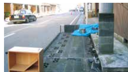
Muro de bloco tombado
