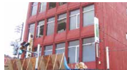
Queda dos vidros quebrados da janela
