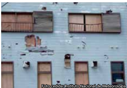
Parede quebrada por objetos arremessados
