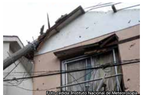
Poste cai e quebra a casa
