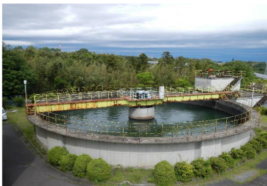
耐震補強工事を実施する 伊坂浄水場排水処理施設※（四日市市）
