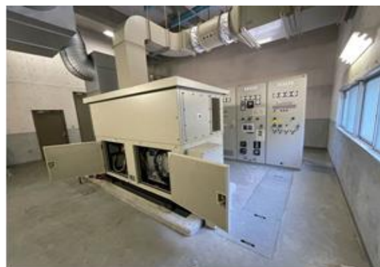
更新予定の志摩送水ポンプ所非常用発電設備 （伊勢市）
