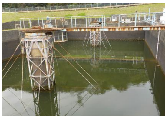
更新予定の山村浄水場汚泥池搔寄機 (四日市市)
