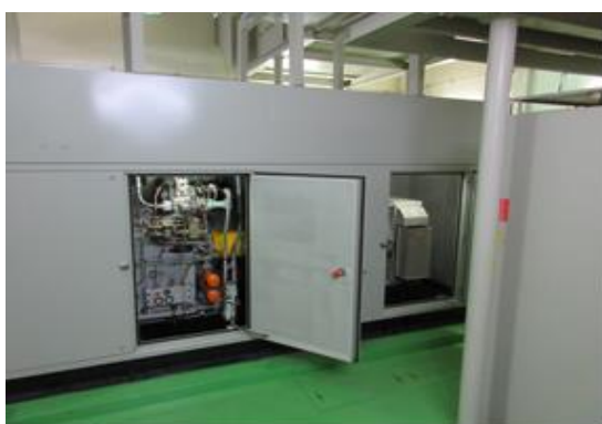
更新予定の高野浄水場非常用発電設備 （津市）
