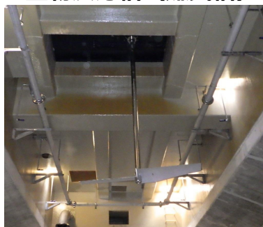
小型化された攪拌機により維持管理を省力化
