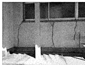
機械制御棟 外壁の亀裂
