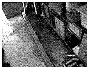
住宅サービス科 床（雨漏りの影響）
