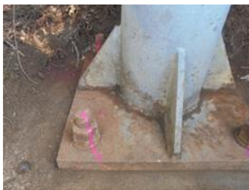
ベースプレートの腐食
