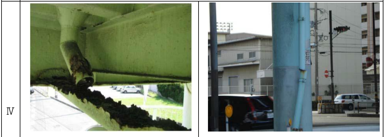
例：腐食により、明らかな断面欠損、貫通や破断がある場合
