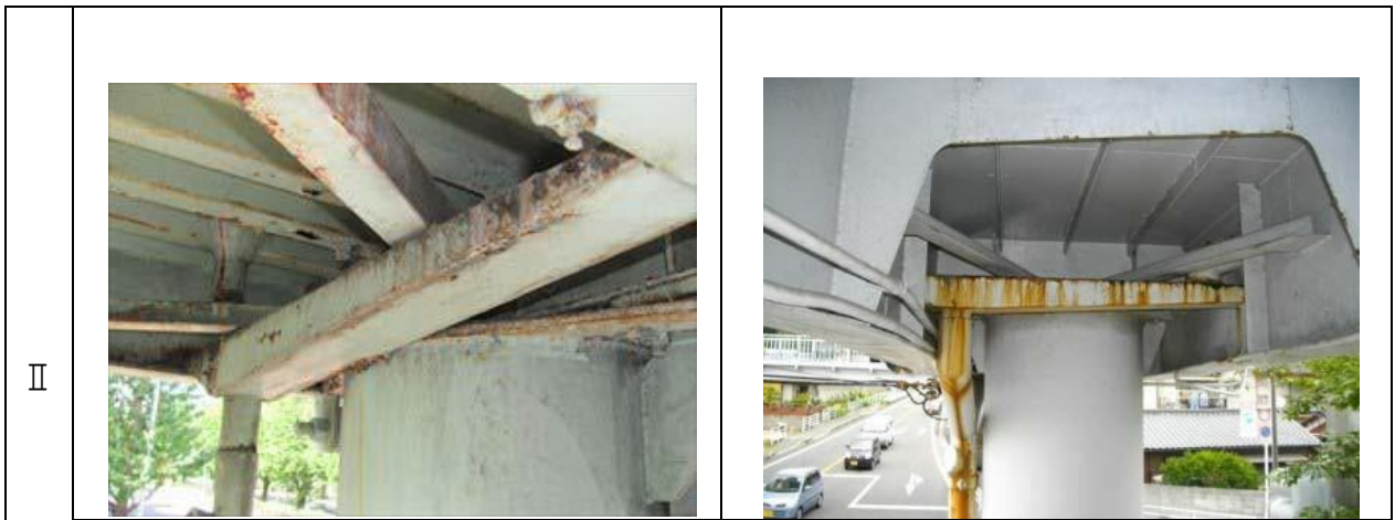
例：局部で腐食が進行しつつあり、放置すると影響の拡大が見込まれる場合
