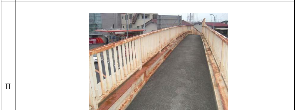
例：広がりのある顕著な腐食が生じており、局部的に明確な板厚減少が確認でき、断面欠損に至ると安全性が損なわれる可能性がある場合
