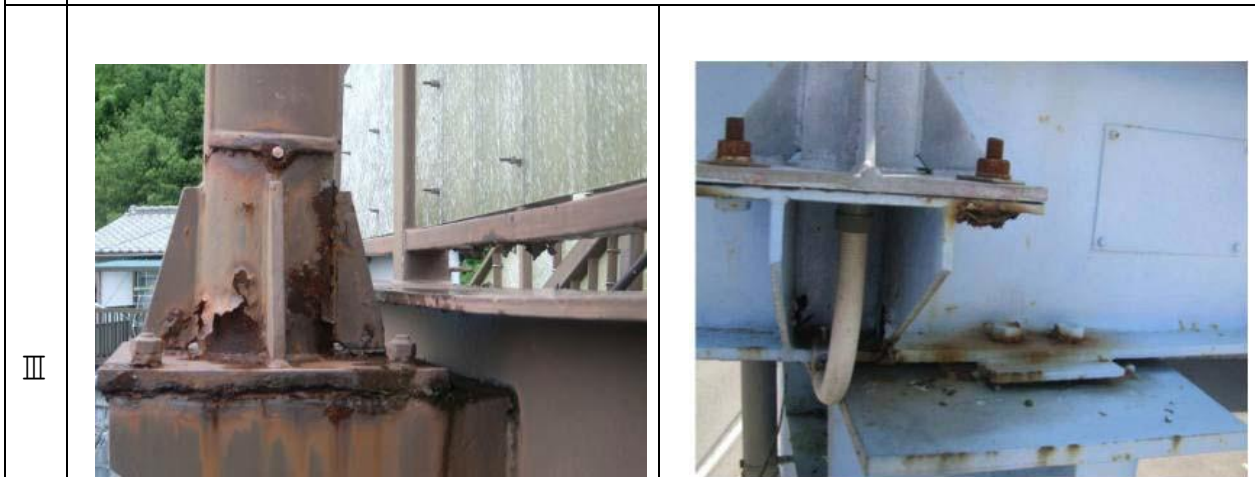
例：広がりのある顕著な腐食が生じており、局部的に明確な板厚減少が確認でき、断面欠損に至ると倒壊一落下する可能性がある場合
