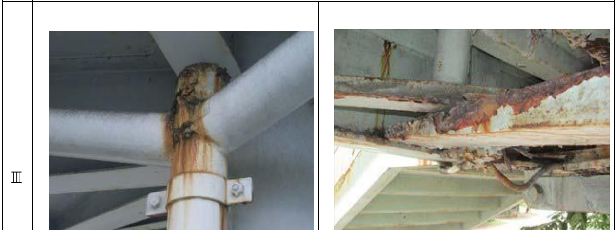
例：広がりのある顕著な腐食が生じており、局部的に明確な板厚減少が確認でき、機能に支障が生じる可能性がある場合
