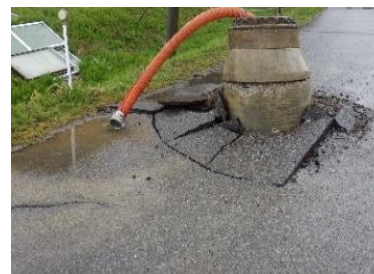
能登半島地震下水道施設被災状況
