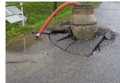
能登半島地震下水道施設被災状況
