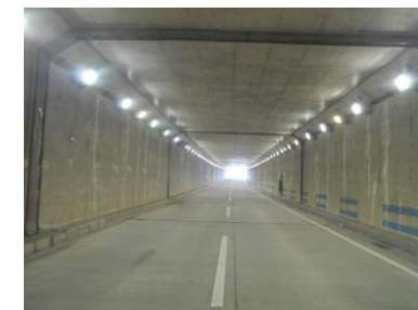
大型カルバート ひびわれ補修
