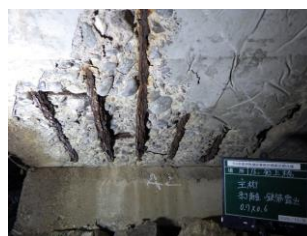
橋梁 Ⅲ判定
