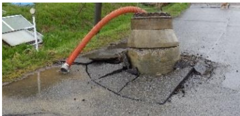
(R6能登半島地震による珠洲市(石川県)下水道施設被災状況)
