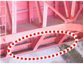
放流ゲートの発錆状況
