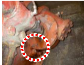
低水放流設備の漏油状況
