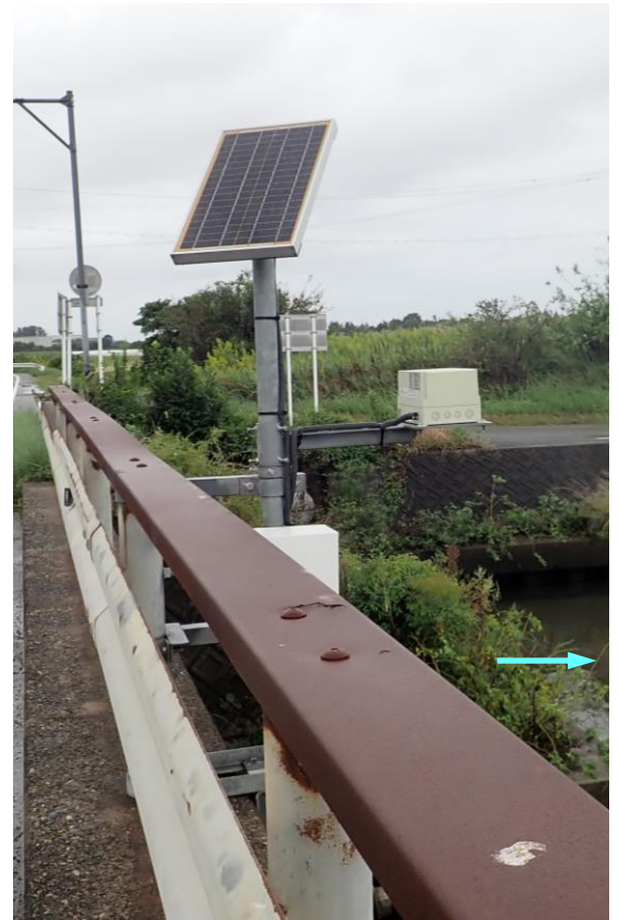
危機管理型水位計 江川橋(県道)
