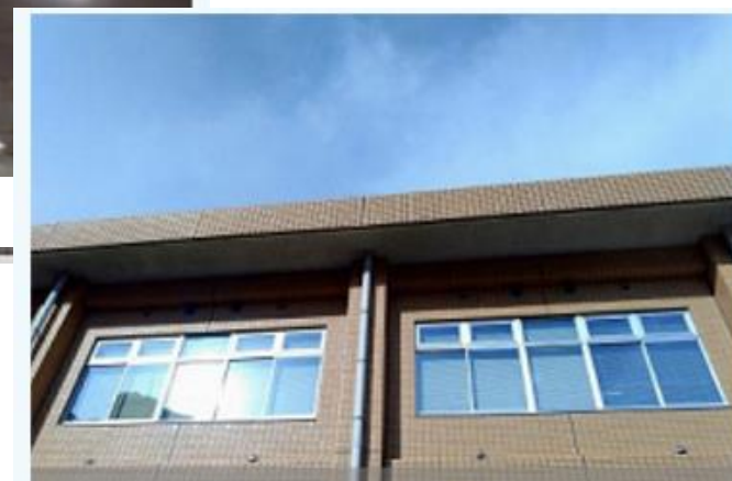
窓のペアガラス
