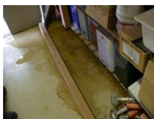
住宅サービス科 床（雨漏りの影響）
