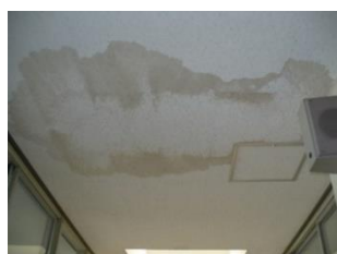
ICTエンジニア科 天井の雨漏り
