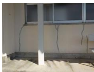
機械制御棟 外壁の亀裂
