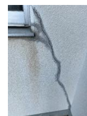
機械制御棟 外壁の亀裂
