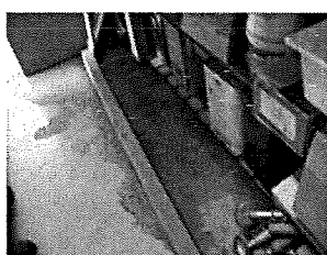
住宅サービス科 床（雨漏りの影響）
