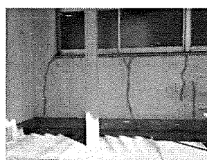
機械制御棟 外壁の亀裂
