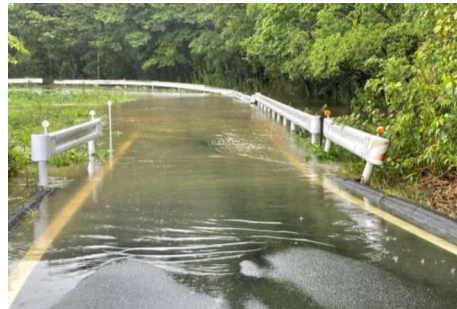
津市内の冠水状況
