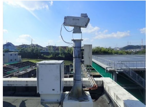
更新予定の北勢水道事務所管内の ITV 設備 ※ (四日市市)
