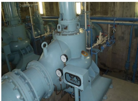
分解点検予定の千本松原取水所 取水ポンプ（桑名市）
