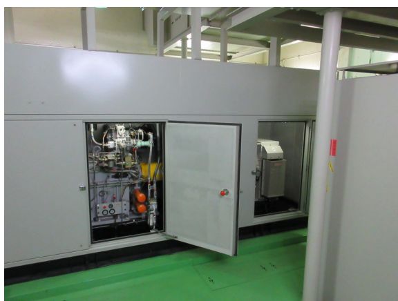
更新予定の高野浄水場非常用発電設備 （津市）
