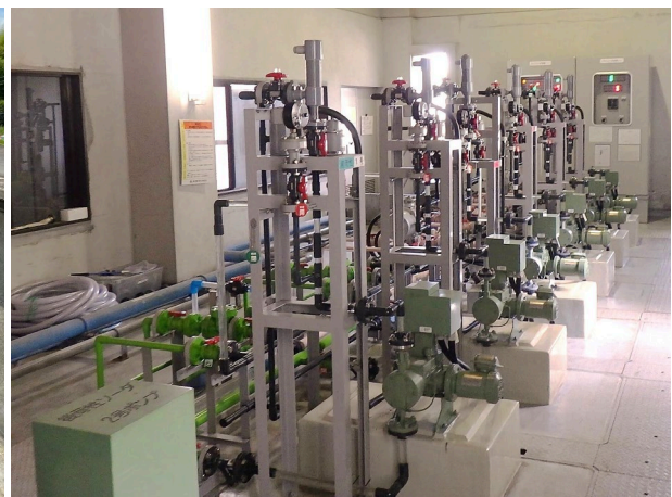
更新予定の播磨浄水場苛性ソーダ注入設備* （桑名市）
