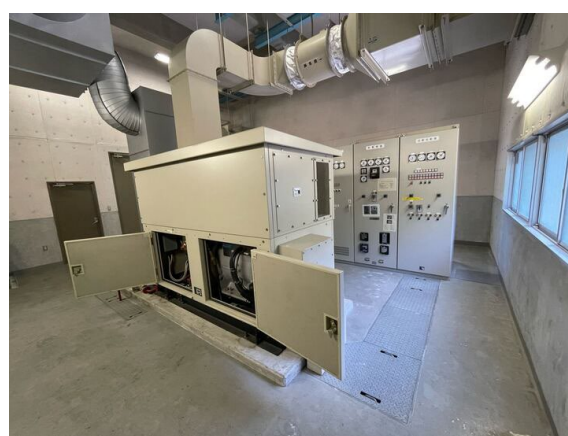
更新予定の志摩送水ポンプ所非常用発電設備 （伊勢市）
