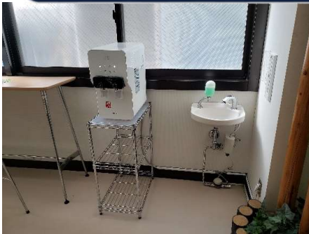
県庁厚生棟地下1階に設置
