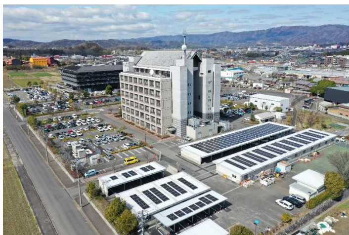
太陽光発電設備(伊賀庁舎)
