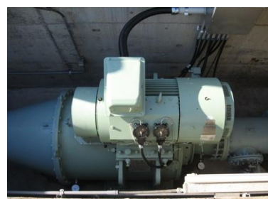
播磨浄水場 小水力発電設備
