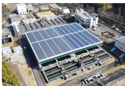
播磨浄水場 太陽光発電設備
