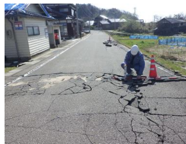
▲災害調査の様子
