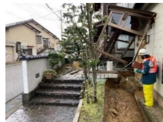
▲応急危険度判定活動の様子
