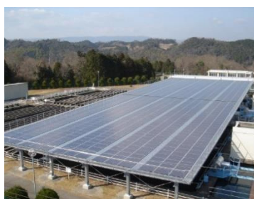
高野浄水場 太陽光発電設備
