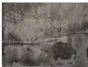
トンネル Ⅲ判定
