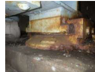
防錆処置 (損傷少)
