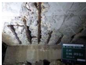
橋梁 Ⅲ判定
