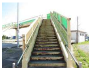
横断歩道橋 Ⅲ判定
