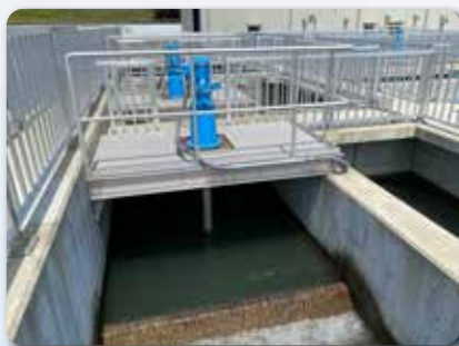
[急速かくはん池]
