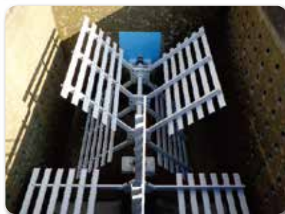
更新した浄水場の緩速攪拌機
