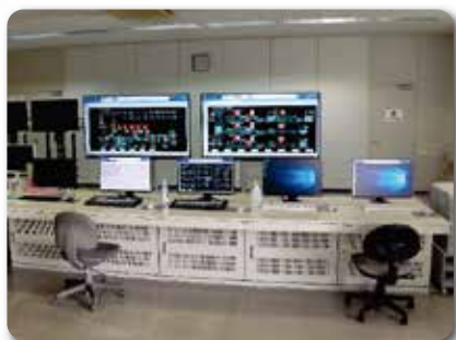
更新した中央監視制御設備
