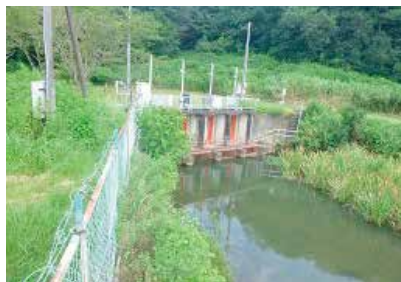
図3.2-2 三重県企業庁高野浄水場取水施設
