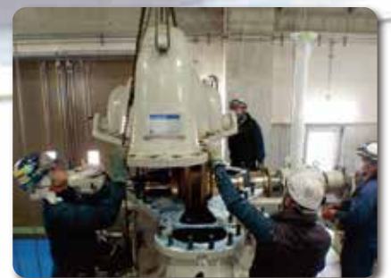
分解点検中のポンプ設備
