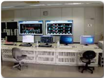
更新した中央監視制御設備
