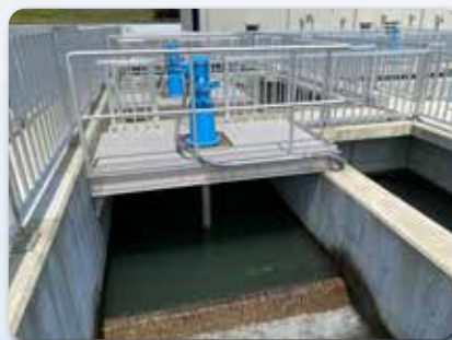
[急速かくはん池]
