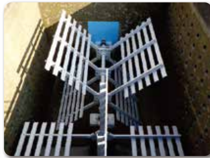
更新した浄水場の緩速攪拌機
