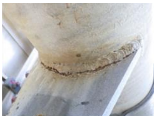
取付金具のき裂
