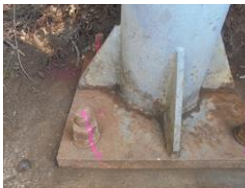
ベースプレートの腐食
