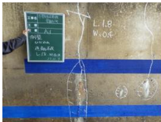
側壁のひび割れ
