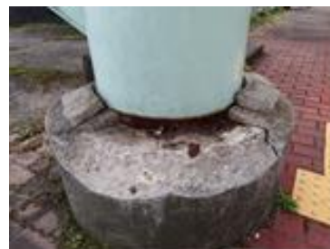
下部構造の腐食
