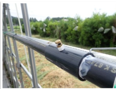
散水噴口の吐出量は6L/分/口です。 1系統あたり6口設置しています。
