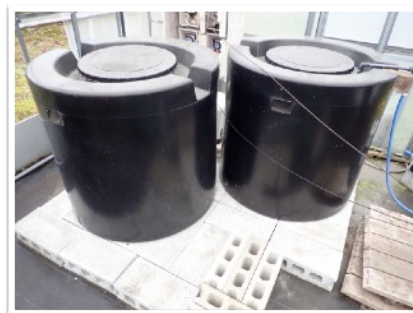
井戸水を受水槽に溜め、併設したポンプから 噴口へ圧送しています。500Lを2基設置して いますが、30分の散水で空になります。
