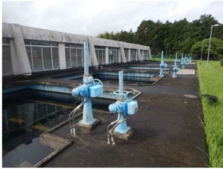
高野浄水場（津市）急速ろ過池電動弁
