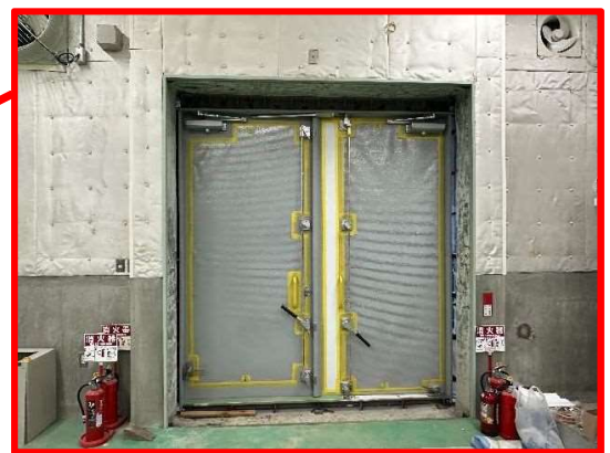
防水扉の設置状況
