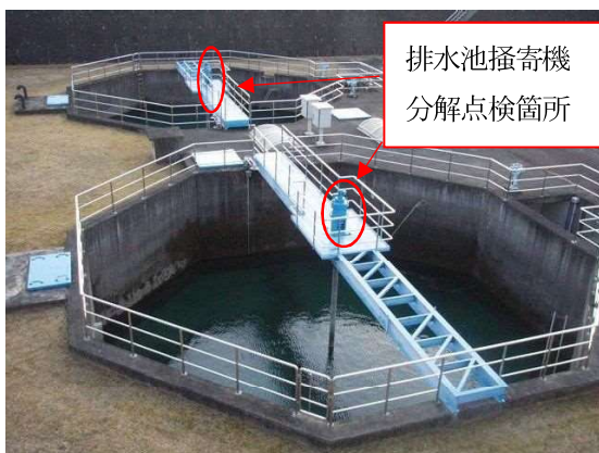
多気浄水場（多気町）機械設備
