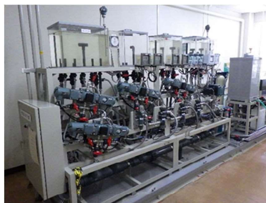
更新予定の山村浄水場（四日市市） 自動水質測定装置
