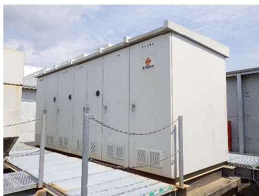
更新予定の北勢水道事務所（四日市市） 受変電設備
