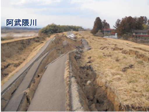
東日本大震災（宮城県阿武隈川） 写真提供：国土交通省東北地方整備局
