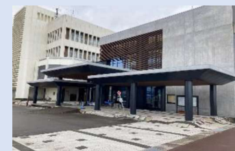
被災した輪島市役所
