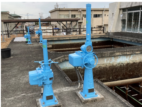
更新後の高野浄水場（津市）急速ろ過池電動弁
