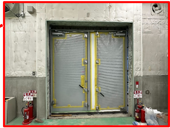
防水扉の設置状況
