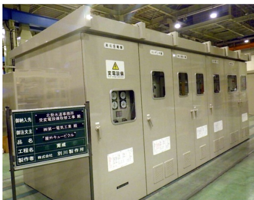
工場製作完了後の北勢水道事務所(四日市市)受変電設備
