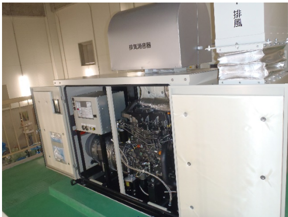
更新後の桑名加圧ポンプ所（桑名市） 非常用発電設備
