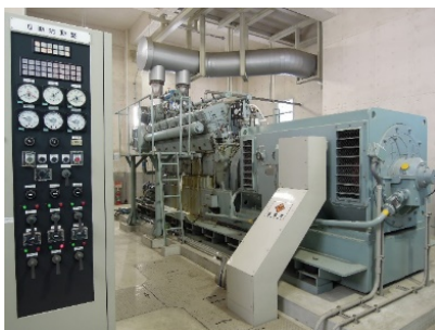
改良予定の施設 （多気浄水場非常用発電設備）
