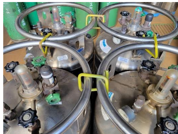
LGC容器の転倒防止措置の例。(伊勢ガスセンター様)
