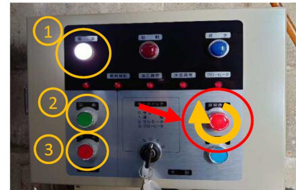
散水ポンプ室
