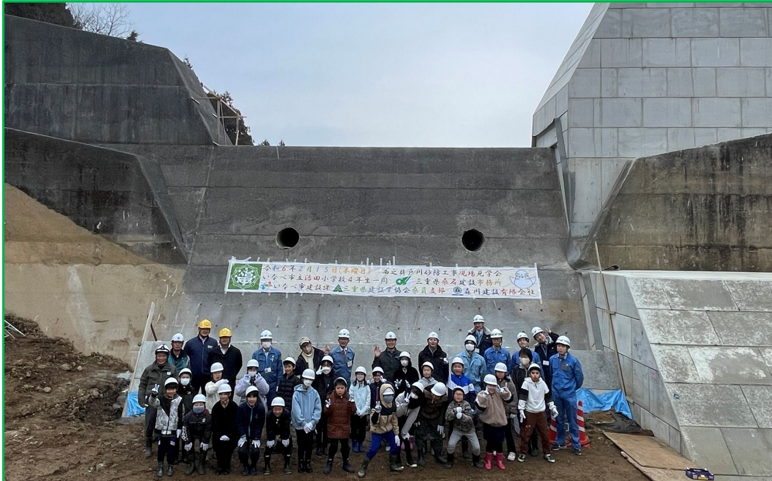
砂防えん堤（嵩上工）工事中の西之貝戸川国補通常砂防（4号えん堤嵩上工）工事現場をバックにして記念撮影 【小学4年生の皆さんの後ろにあるのが現在嵩上げ工事中の砂防堰堤です。】
