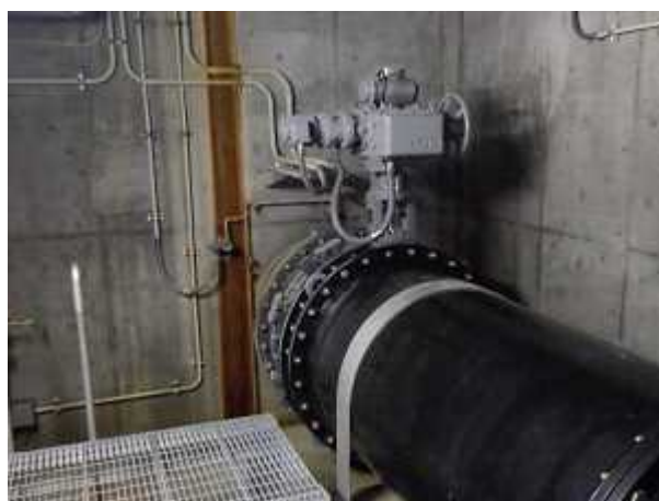
新羽津流量調整弁室(四日市市)
