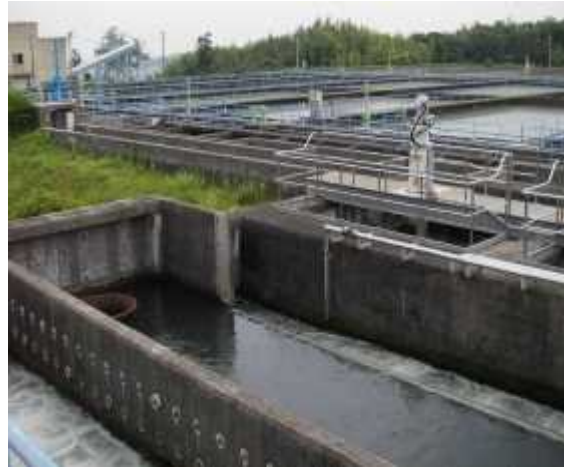
伊坂浄水場(四日市市・員弁川)
