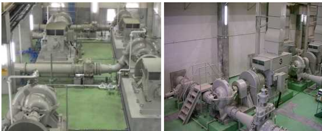
野代導水ポンプ所のポンプ設備
