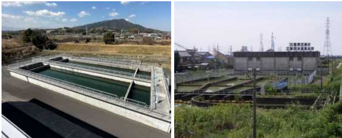
野代導水ポンプ所(桑名市・長良川)の沈砂池 安永取水所(桑名市・員弁川)の沈砂池
