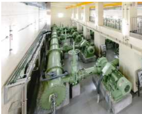
大矢知加圧ポンプ所(四日市市)
