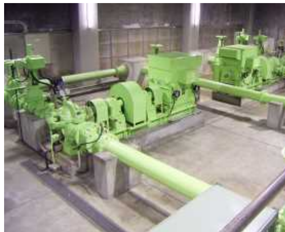
長太加圧ポンプ所(鈴鹿市)
