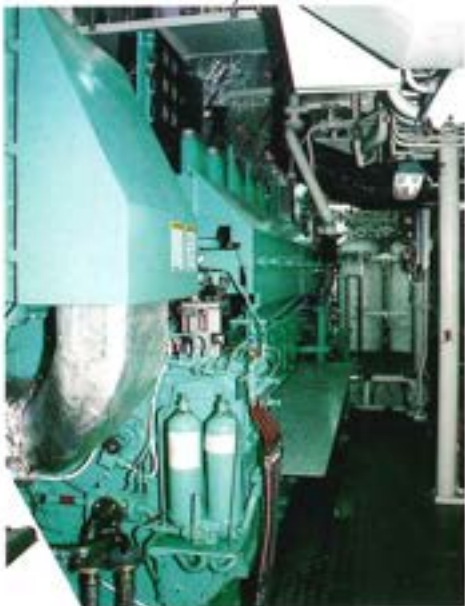
▲機関室 (ENGINE ROOM)
