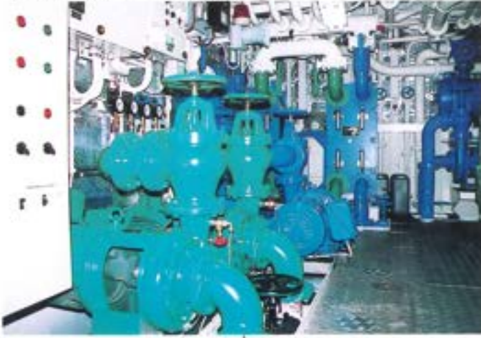
▼機関室 (ENGINE ROOM)
