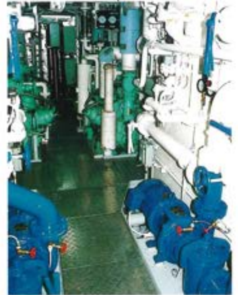
▲冷凍機室 ポンプアレイ (REF. MACH ROOM PUMP ALLEY)
