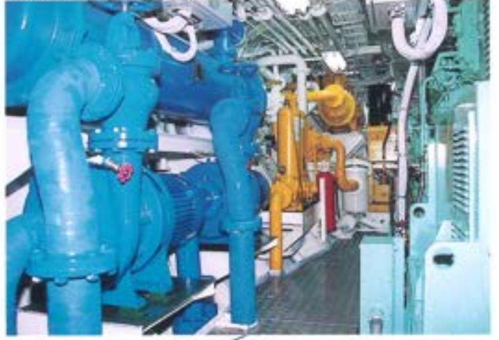
▼機関室 (ENGINE ROOM)
