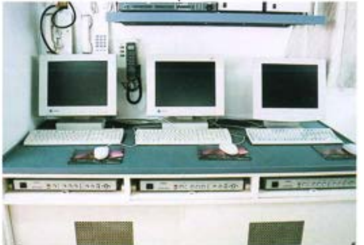
▲LANシステム (LAN SYSTEM)
