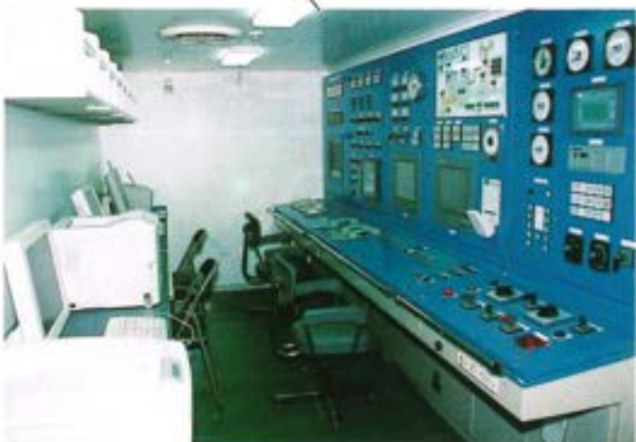
▲機関制御室 (ENGINE CONTROL ROOM)
